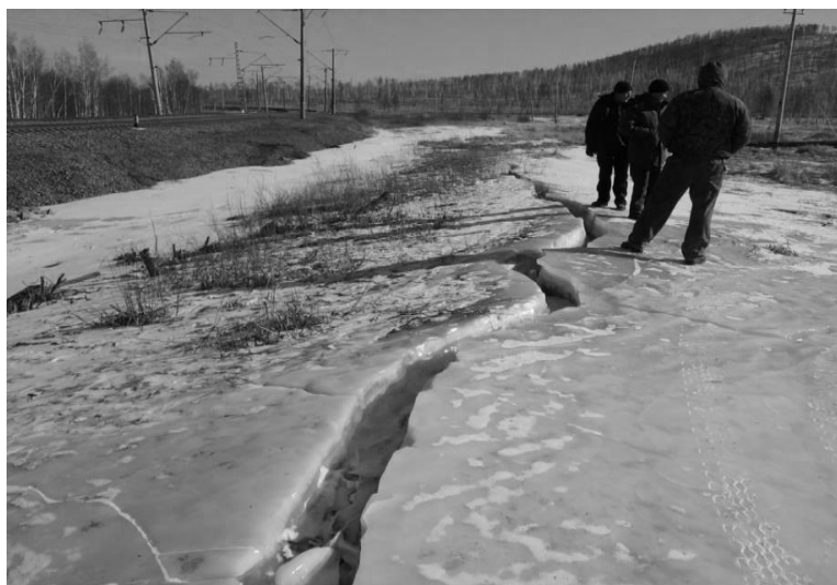
Рисунок 1 – Рост бугра наледи с четной стороны насыпи
